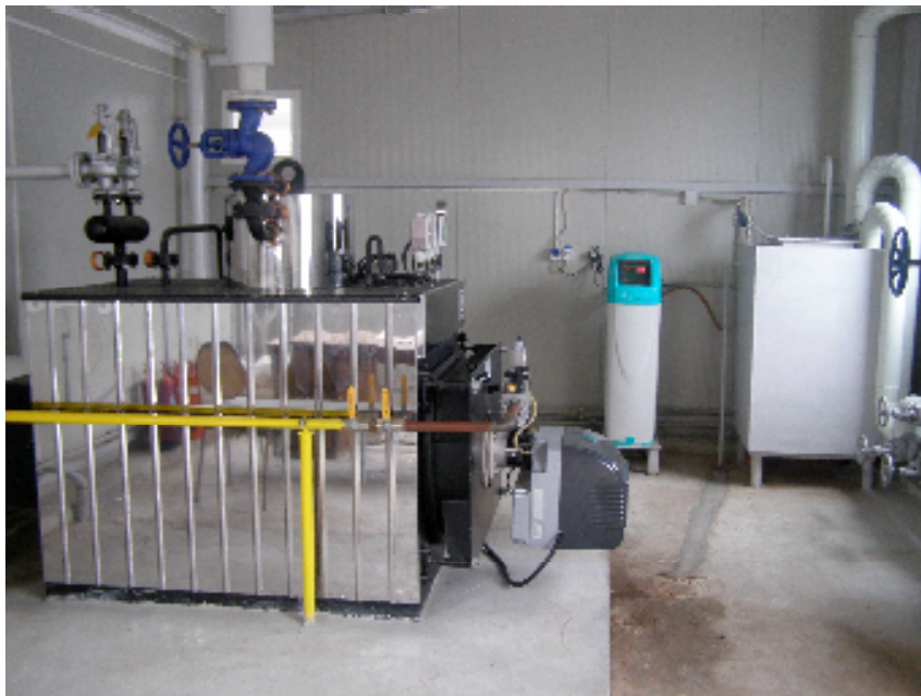
Foto: Centrala termica
